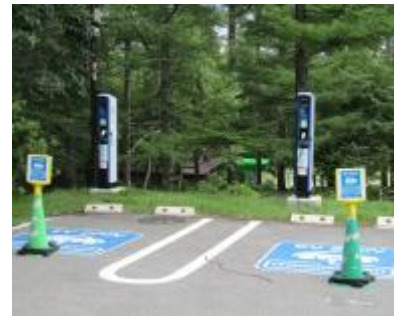
電気自動車用充電スタンド 《ホテル客用駐車場》 ・2014年11月設置
