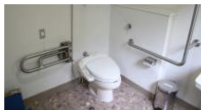
障がい者用トイレ(施設内)
